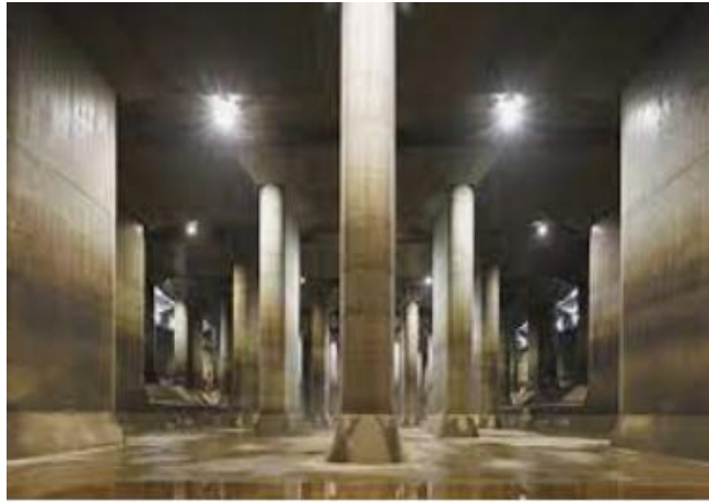
首都圏外郭放水路
